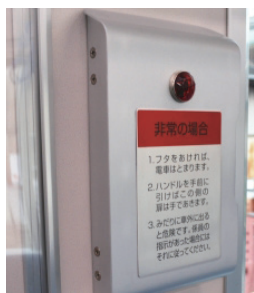
非常通報装置
