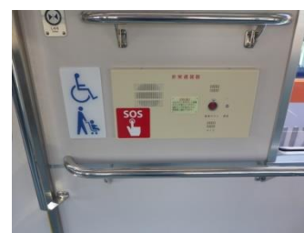
非常通話装置
